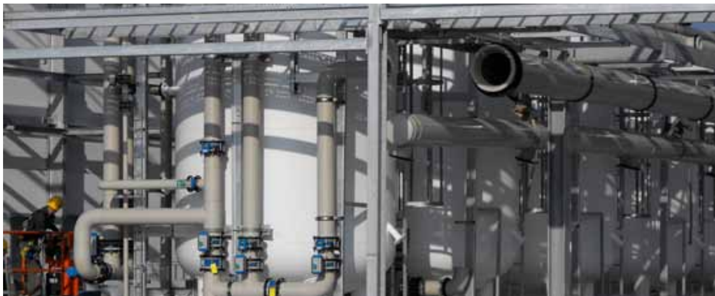
De mengbedketels voor polishing van demiwater.
