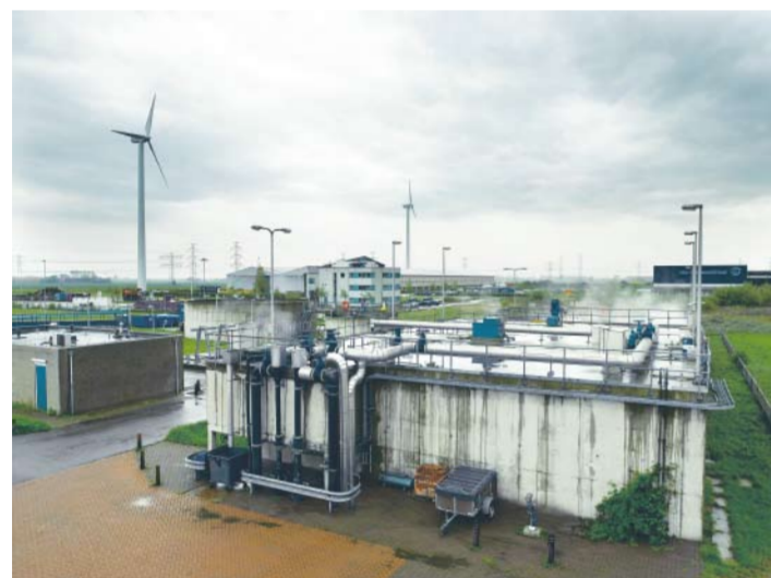
Industriekläranlage im Industriegebiet von Vlissingen
