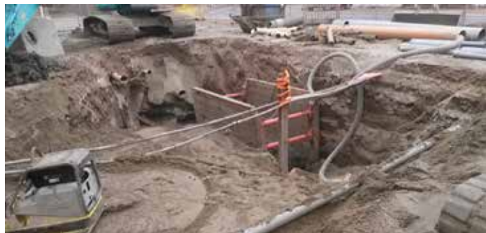
Sleuven voor rioolwerk zijn vaak breder en dieper dan voor de kabels en leidingen van de nutsbedrijven.
